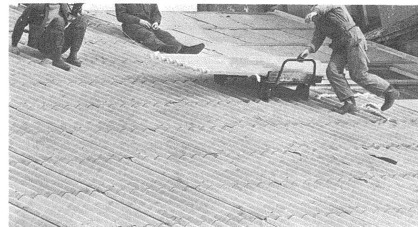
Livsfarlige situationer på et tag med Eternit-bølgeplader. Pladerne transporteres på en vogn med gummihjul direkte på taget. Tagdækkerne færdes helt uden sikkerhedsforanstaltninger direkte på taget og træder endog i pladefelterne.
